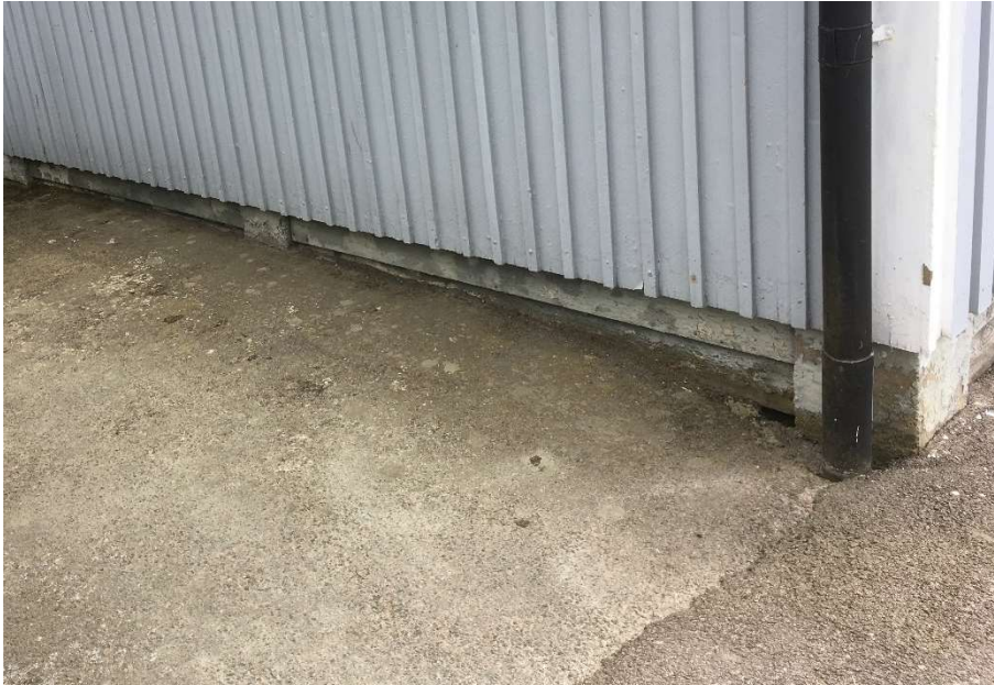
Bild 6. Tecken på pågående sättningar längs husets grund.
