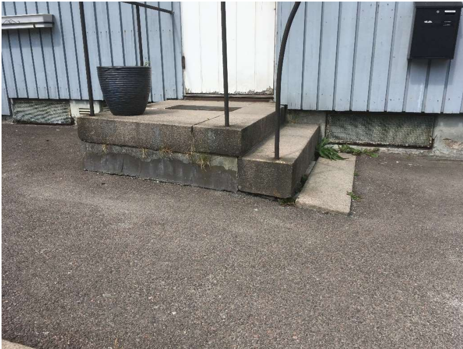
Bild 7. Tecken på pågående sättningar vid trappan.
